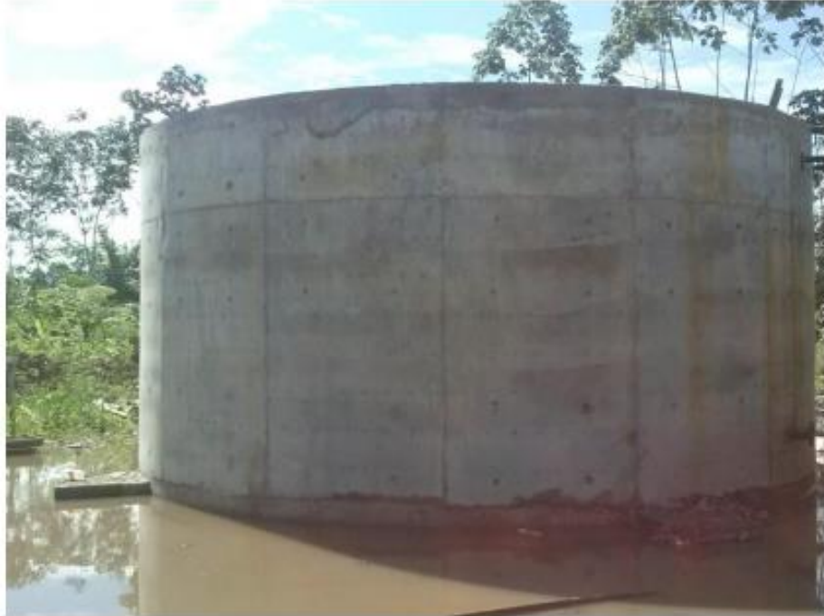
Tanque de agua potable.
