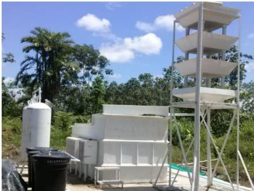
Planta de tratamiento de agua potable (PTAP)
