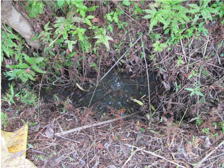
Cuneta en tierra con sedimento
