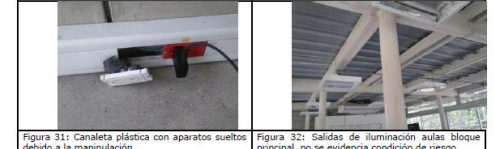
Figura 31: Canaleta plástica con aparatos sueltos debido a la manipulación. Figura 32: Salidas de iluminación aulas bloque principal, no se evidencia condición de riesgo.
